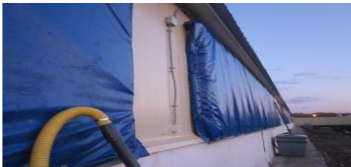
Рисунок 1 – Кассеты водоиспарительного охлаждения, утепленные тентами на зимний период
