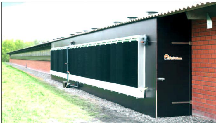
Рисунок 2 – Системы с увлажняющими матами (расположение вдоль фасадной стены)
